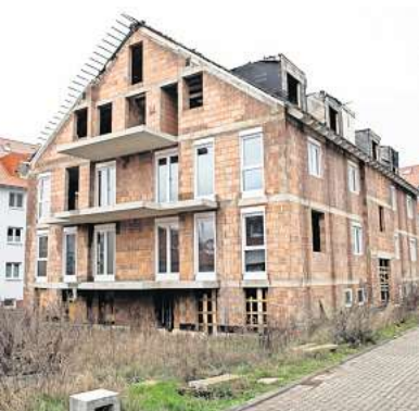
Dieser Neubau im Kiesel-Carrée muss abgerissen werden, urteilte das Verwaltungsgericht. FOTO: PFÖRTNER
